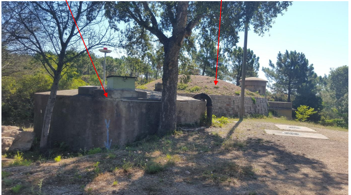
Réservoir maintenu et végétalisé
