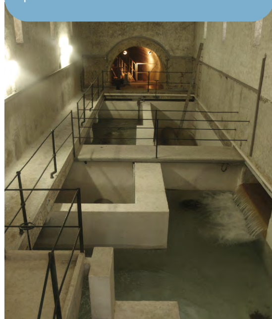
Captage de Bramafan
