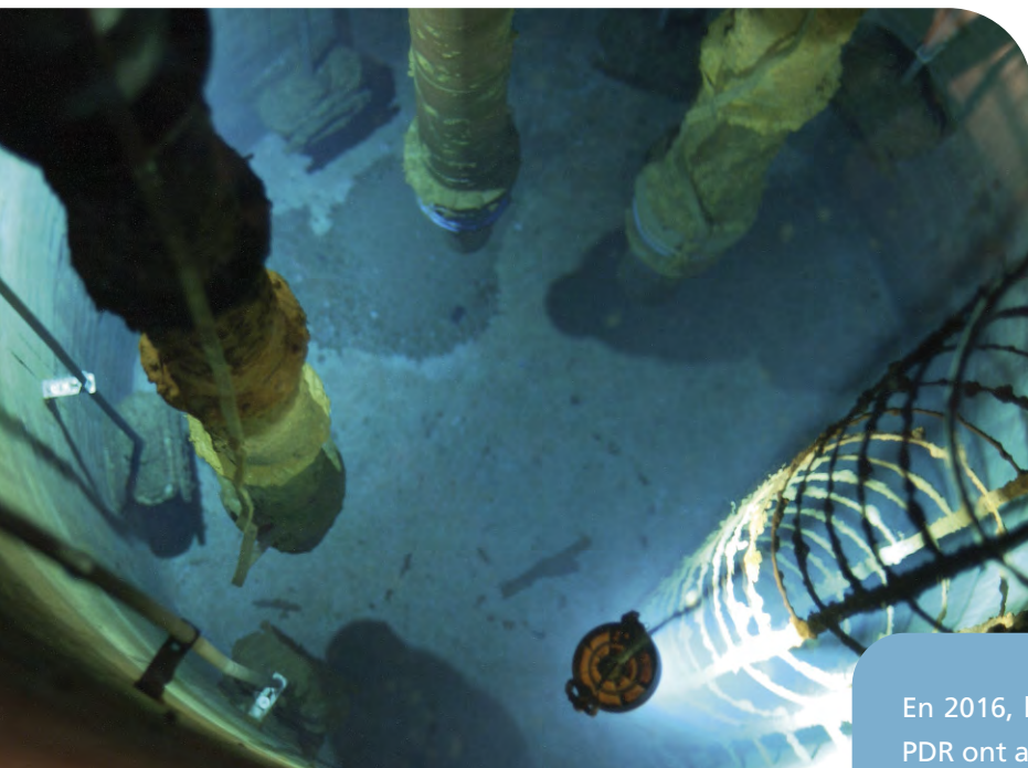
Puits à drains rayonnants
