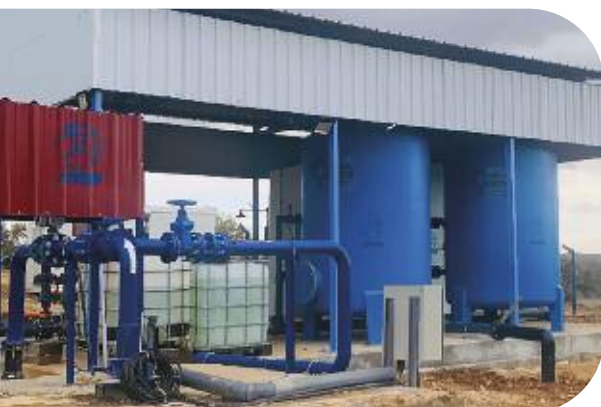
Petite unité de traitement des eaux abritée
