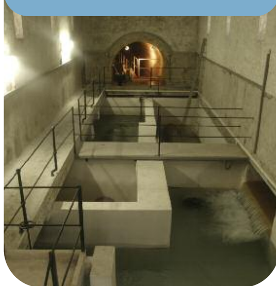
Captage de Bramafan
