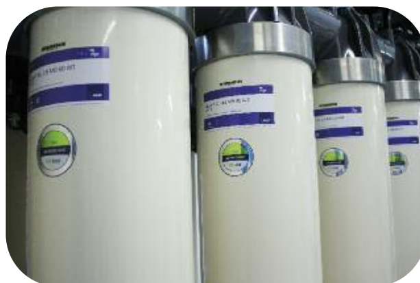
Mars 2017 - changement des membranes d'ultrafiltration
