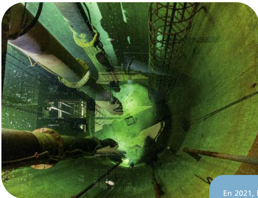
Puits à drains rayonnants
