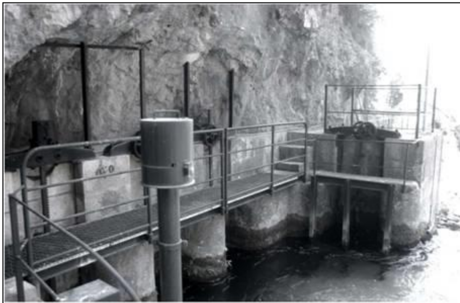
Vanne du captage en rivière de Saint-Cézaire
