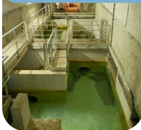
Captage de Bramafan
