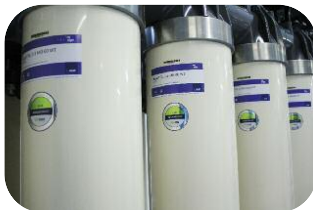
Mars 2017 - changement des membranes d'ultrafiltration
